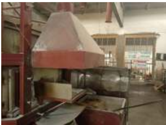
图 3-2 南玻璃车间除尘器
