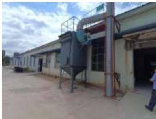
图 3-3 配料车间除尘器
